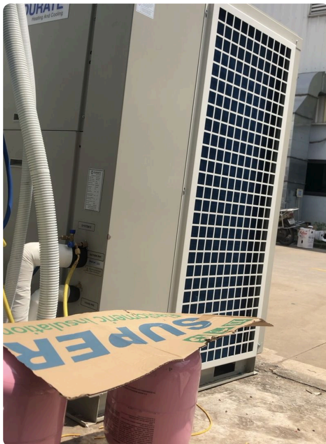
Nạp gas R410A cho cụm dàn nóng AHU Durate
